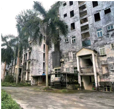
澳洲山莊項目部分爛尾樓。
